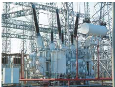
Электрические сети Электростанции, подстанции, линии электропередач
