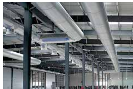
Системы инженерных коммуникаций
